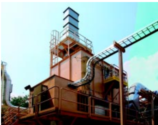
Unidade de 40 000 Nm 3 /h montada sobre plataforma.
