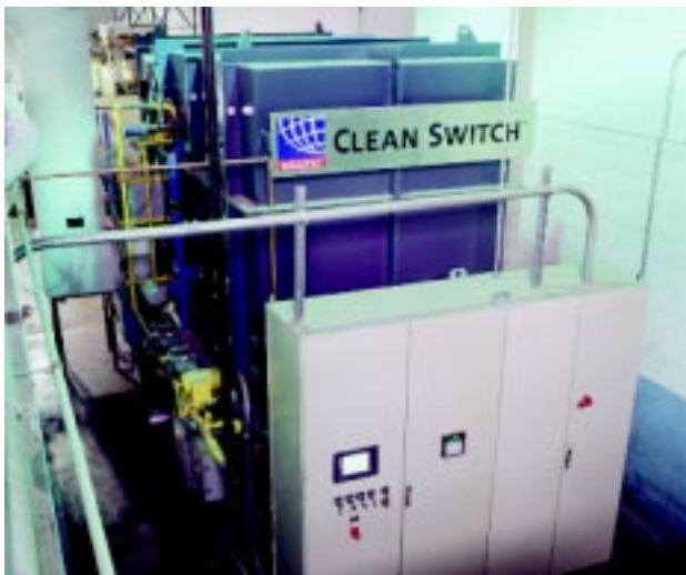
Unidade de 10 000 Nm 3 /h instalada no interior sem cabina de controlo.
